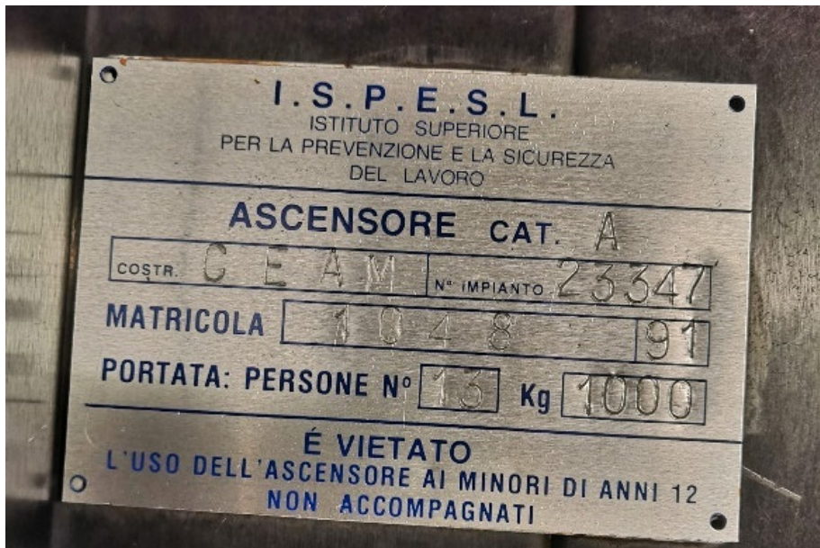
Figura 6: Vecchia targa impianto ascensore n.3
