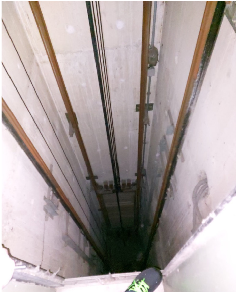
Figura 3: Foto vano corsa ascensore 2.
